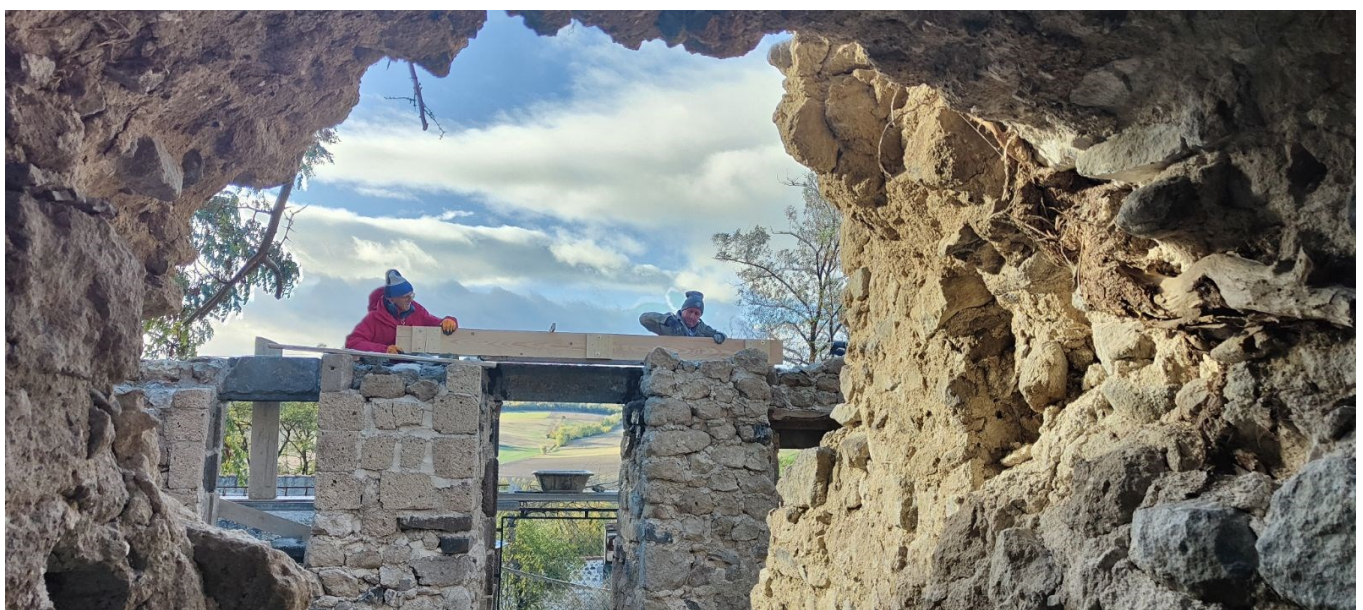
Coffrage du linteau de la porte principale de la maison Parpaleix lors d'une opération coup de poing
